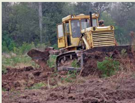
Механизирано разчистване на площите от стари дънери и растителност и непосредствена почвообработка
